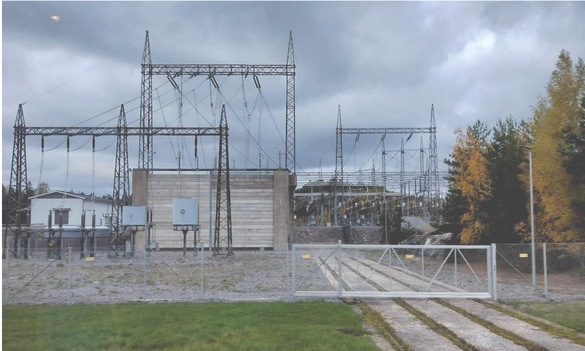
Kuva 22. Fortum Oyj:n sähköasema kaava-alueen lounaisreunassa- Kuva: FCG, Arja Sippola, 8.10.2024
